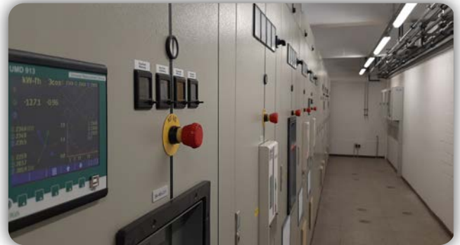
Energiemessgeräte auf der Kläranlage Paderborn
