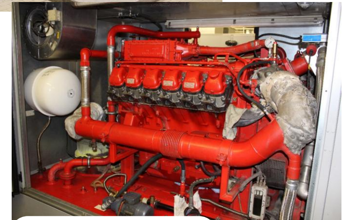
BHKW-Anlage mit 3 Modulen mit jeweils 360 kW elektr. Leistung 473 kW therm. Leistung
