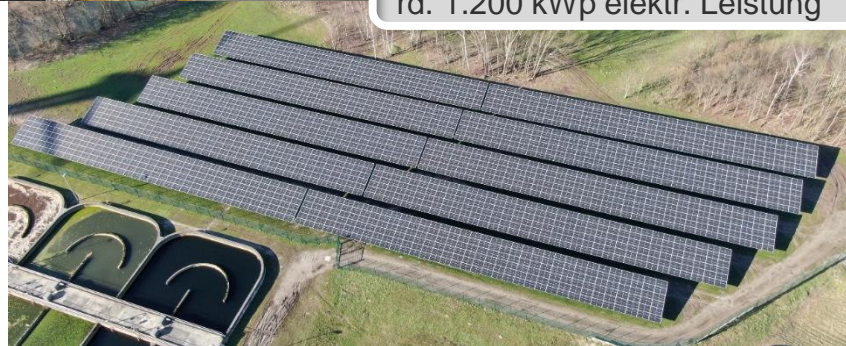
PV-Anlagen rd. 1.200 kWp elektr. Leistung
