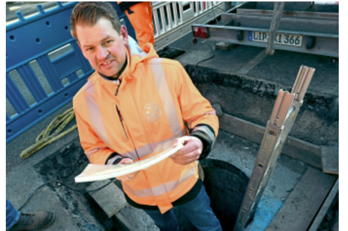
Bauleiter Korbinian Festing von der Firma Rainer Kiel Kanalsanierung zeigt ein Stück von dem Schlauchliner, der in den Kanal eingezogen wird. Damit soll der Kanal für weitere 50 Jahre halten. Foto: Ingo Schmitz
