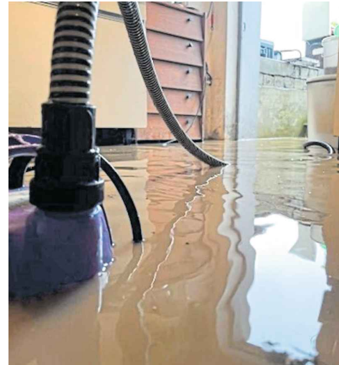
... und laufende Pumpen.
