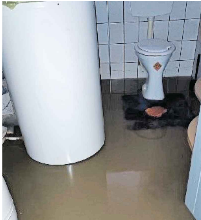
Die Folgen des Hochwassers sorgen noch für vollgelaufene Keller ...
