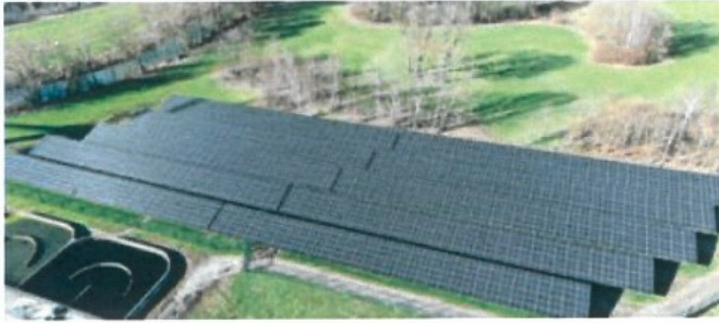
Ab Mai soll die Photovoltaik-Anlage auf dem Gelände der Kläranlage in Paderborn-Sande Strom liefern. Foto: STEB
