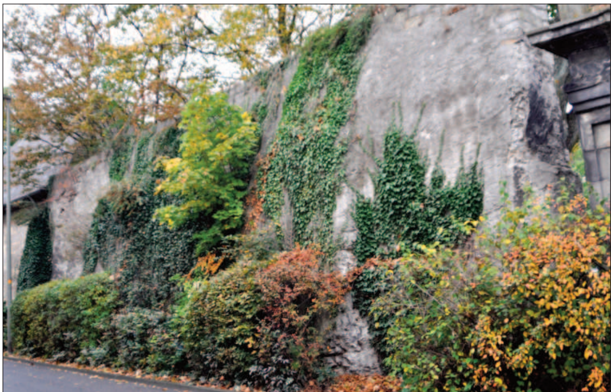
Abb.7: Ein derart üppiger Bewuchs von Mauerkrone und Mauerwand ist im Siedlungsbereich eher selten zu finden (Westernmauer/Kiesau).
